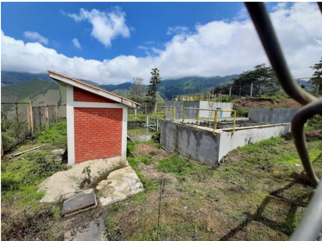
Nota. Planta de Tratamiento de aguas residuales domésticas CP. San Jorge.
