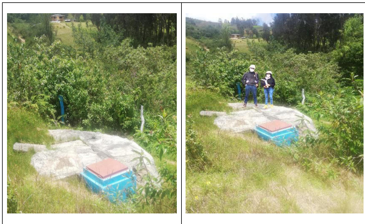
Captación Yerba Buena 01
