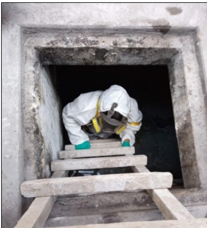
Cisterna de desorción de carbón activado
