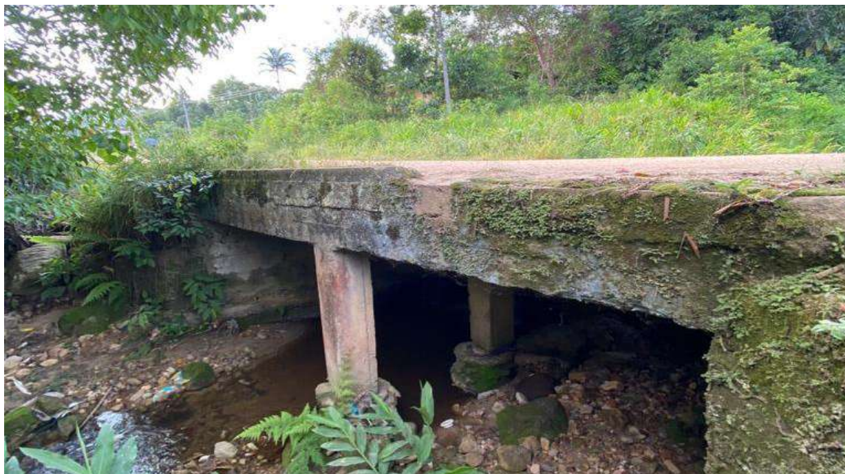
Figura 47. Vista de un pontón antiguo que une a los barrios La Unión y San Juan del Arenal en el Jr. Arica. Fuente: Toma personal, 2021.
