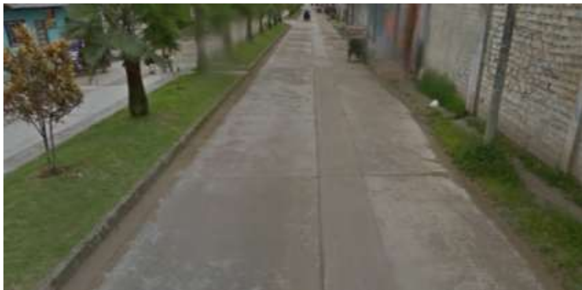
Fotografía 7: Calle pavimentada sin vereda peatonal
