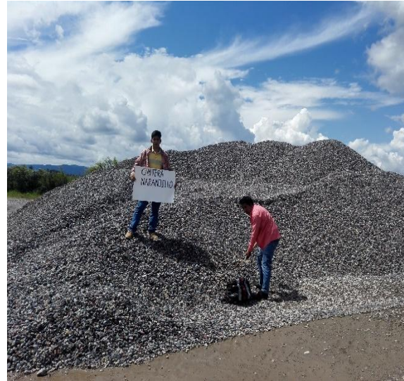
Imagen 5. Recolección y muestreo de los Agregados gruesos en la planta procesadora Túmbaro
