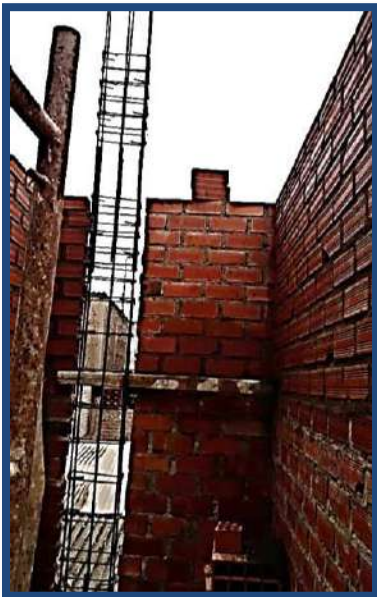
Figura 37. Mala conexión entre la columna y el muro Fuente: Propia
