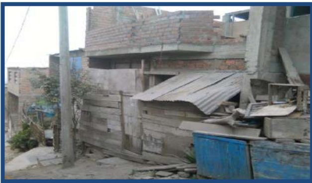
Figura 34. Falta de arriostamiento en elementos no estructurales Fuente: Propia
