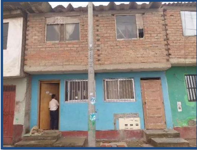
Figura 36. Muros sin arriostramiento por los voladizos Fuente: Propia
