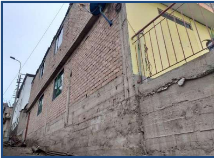
Figura 24. Viviendas con cimentación expuesta
