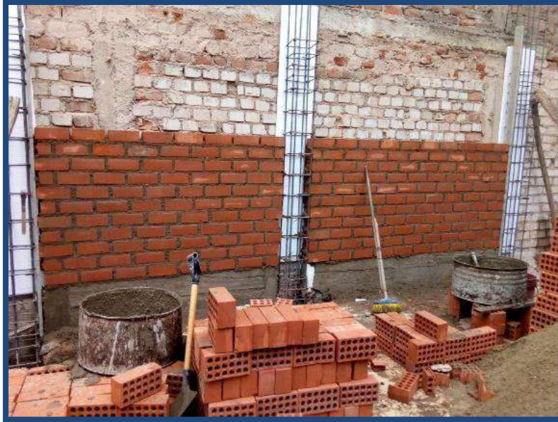
Figura 25. Mala conexión entre la columna y el muro
