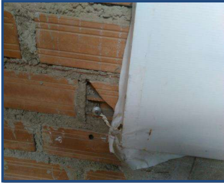
Figura 26. Mala calidad de las unidades de albañilería Fuente: Propia
