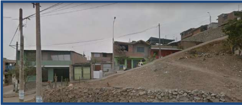
Figura 38. Empuje lateral que soportan los muros de las viviendas por la topografía en estudio Fuente: Propia
