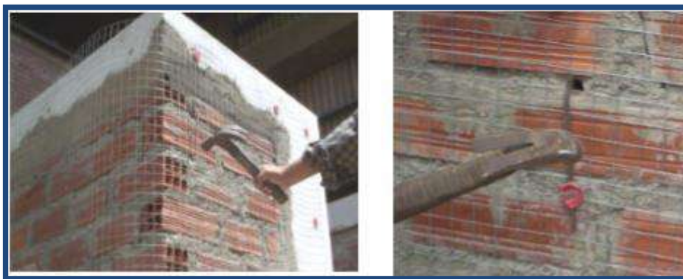
Figura 62. Alambres conectores con la malla electrosoldada Fuente: San Bartolomé, Arata y Diaz 2004
