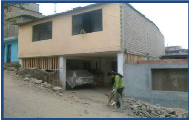
Figura 7. Presencia de piso blando en la vivienda Fuente: Propia
