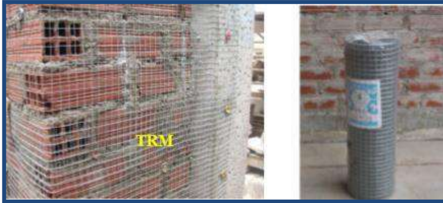
Figura 61. Malla electrosoldada arriostrando el muro a la columna Fuente: San Bartolomé, Arata y Diaz 2004
