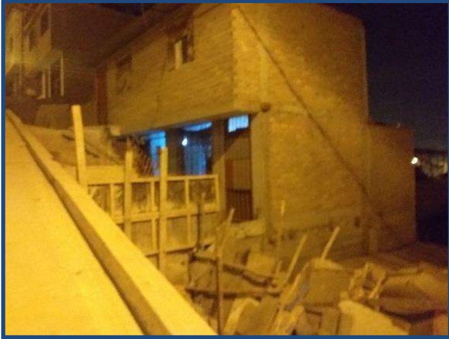
Figura 28. Vivienda con cimentación expuesta, construida en pendiente Fuente: Propia
