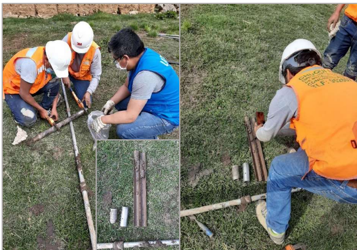
Figura 203. Retiro del muestreador, verificación de muestra extraída, ensayo SPT-01. Fuente: Elaboración Propia.
