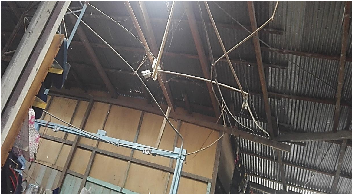
Figura 12. Cableado eléctrico, parte interna del mercado José Olaya. Fuente: Elaboración propia.
