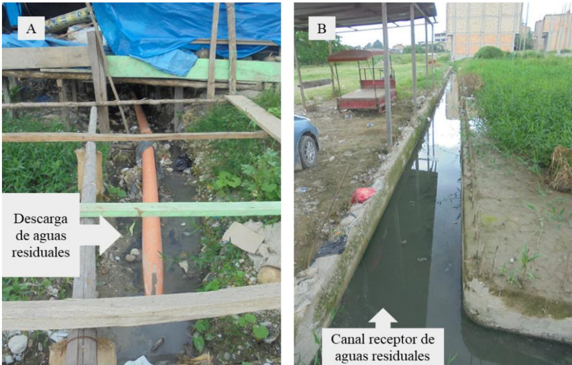
Figura 23. Descarga de aguas residuales (A) y canal receptor de aguas residuales del mercado José Olaya y alrededores. Fuente: Elaboración propia.
