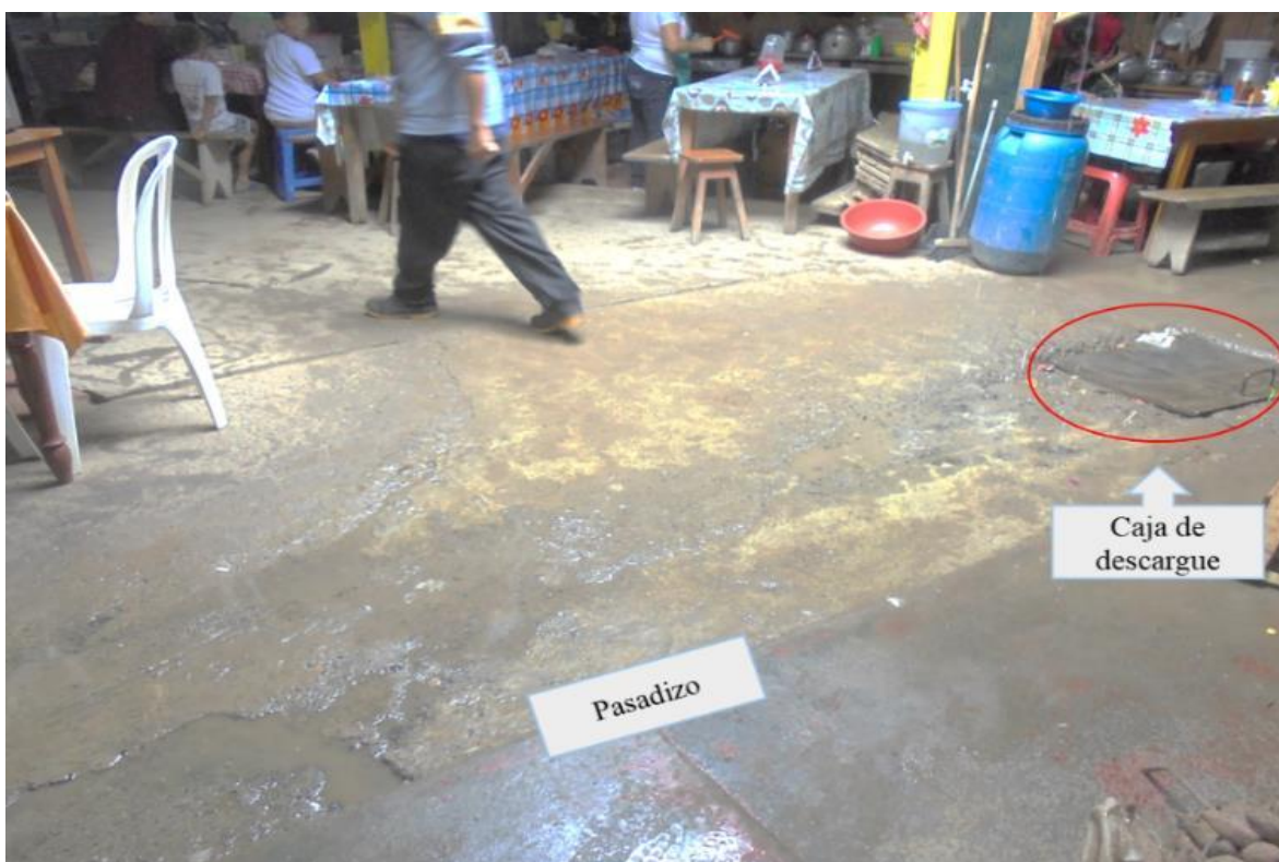
Figura 25. Descarga superficial de agua residual por los pasadizos del sector D, mercado José Olaya. Fuente: Elaboración propia.
