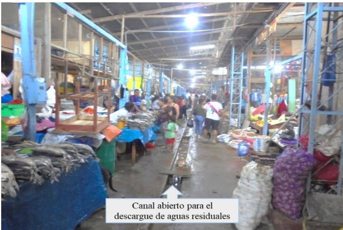
Figura 24. Descarga de aguas residuales, sector A, mercado José Olaya. Fuente: Elaboración propia.
