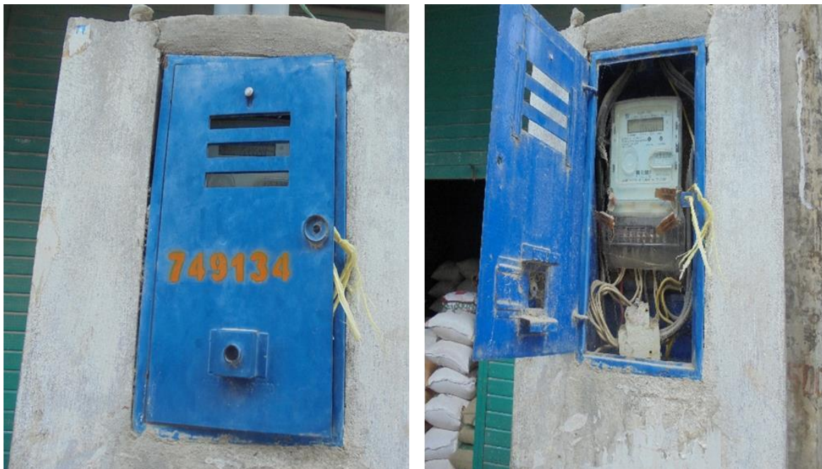
Figura 13. Caja de medidores de energía eléctrica en el mercado José Olaya. Fuente: Elaboración propia.
