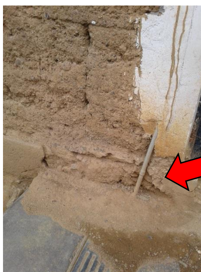
Anexo 10. Desmoronamiento y desintegración del adobe en forma de barro.
