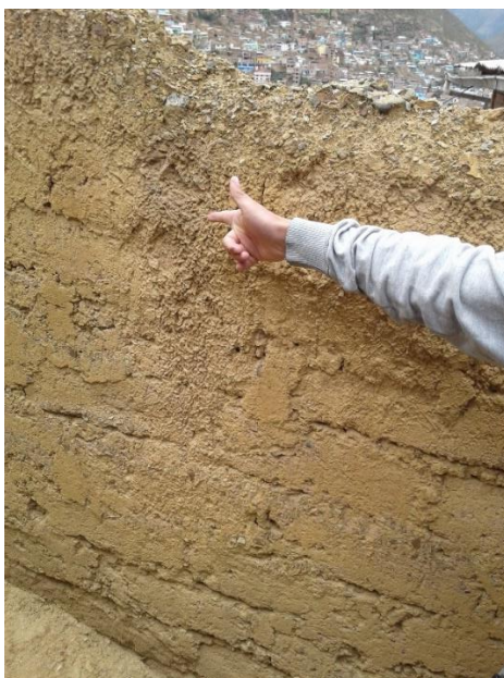
Anexo 12. Muro de adobe afectado por lluvias y humedad que lo producen.
