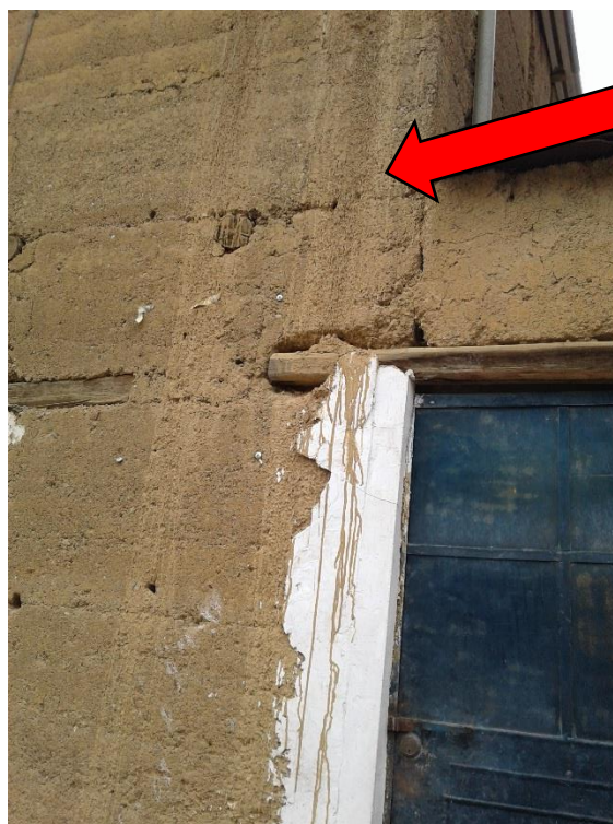
Anexo 9. Fachada de vivienda afectada por las lluvias.
