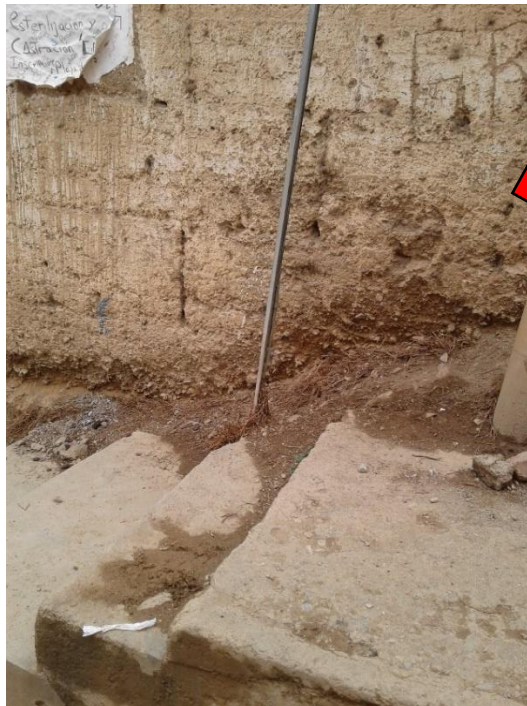
Anexo 14. Muro de adobe desintegrándose.
