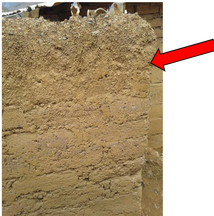
Anexo 11. Desintegración del adobe.
