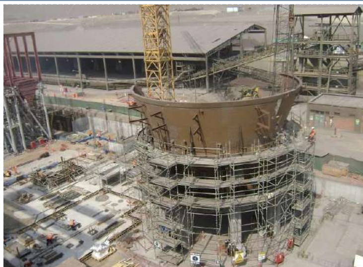
Área 25: Nueva planta de Tostación
