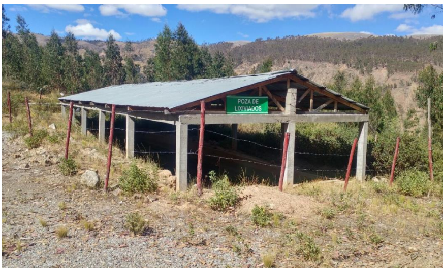
Figura 15. Poza de lixiviados del relleno sanitario Pampaya
