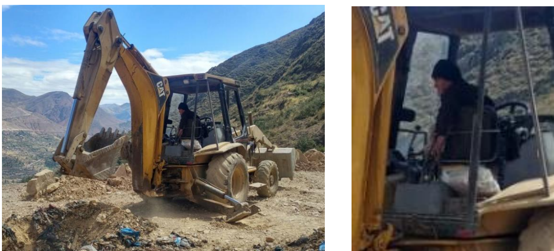
Figura 20. Operario de la retroexcavadora sin el equipo de protección personal (E.P.P.)
