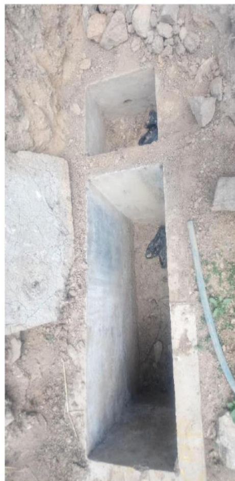
Figura 3. Se aprecia la Cámara Rompe Presión en Red de Distribución que no existen los accesorios.
