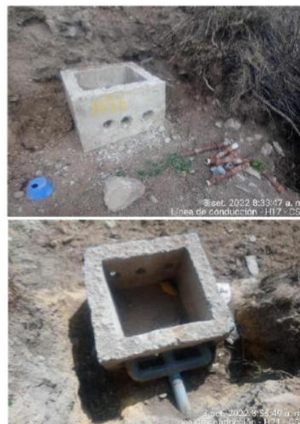
Figura 4. Estructura existente de Cámaras de Distribución
