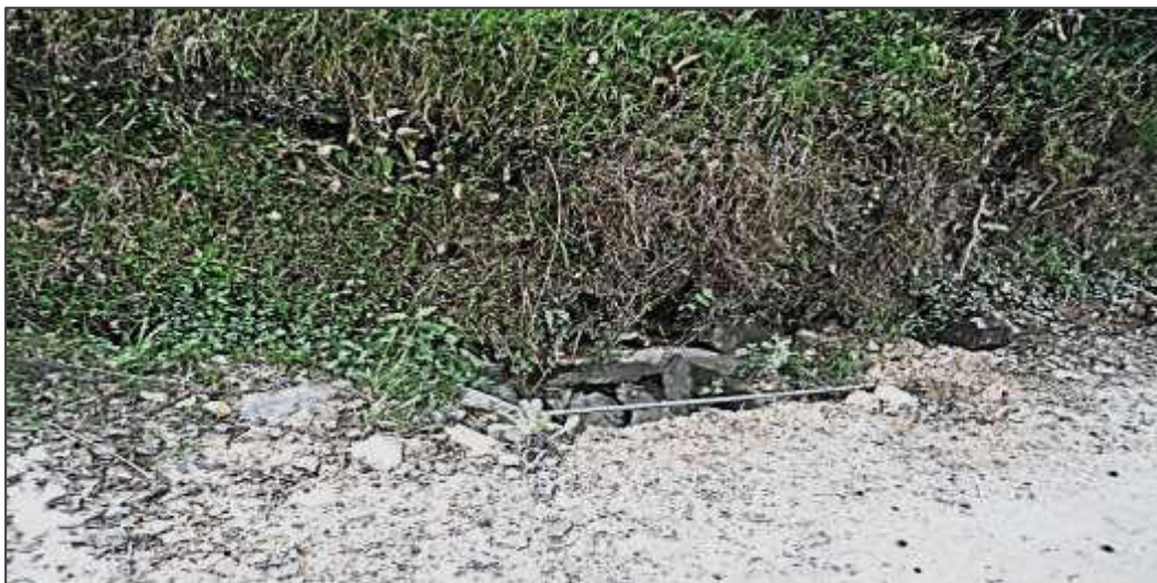
Imagen 7. Alcantarilla de concreto (L=2.40m A=0.80m H=1.20m), en la progresiva 01+738 km, en estado regular
