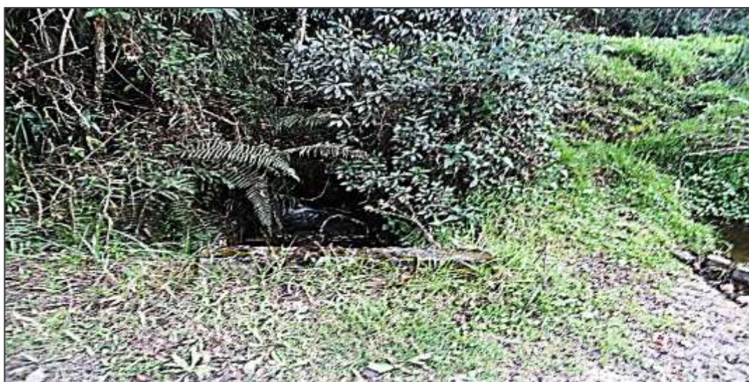
Imagen 8. Alcantarilla de concreto (L=2.20m A=0.60m H=1.20m), en la progresiva 01+754 km, semicolmatada y con vegetación.
