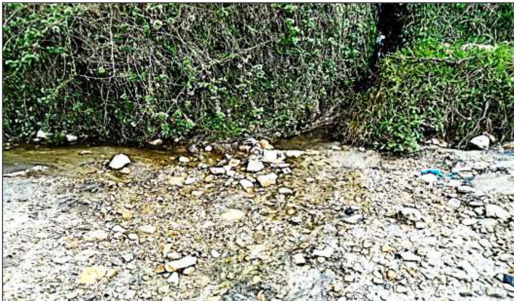
Imagen 3. Badén de tierra en la progresiva 00+072 km (A=5m L=7m)
