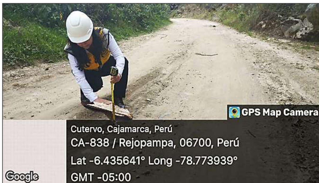
Imagen 11. Evaluación del nivel de gravedad mayor a 10 cm en la progresiva 3+500 km de deformación
