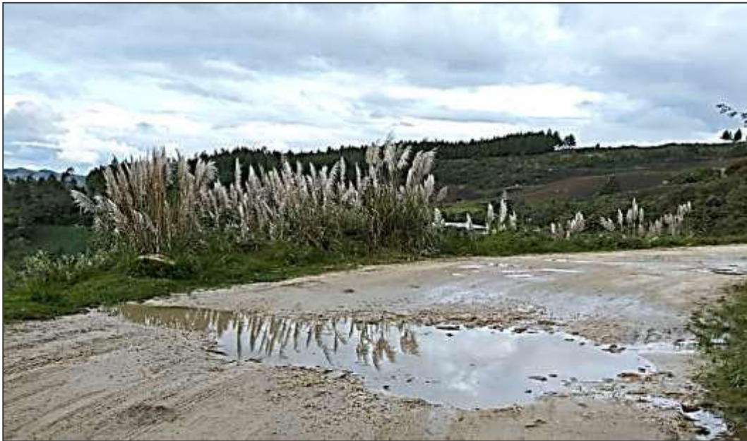
Imagen 6. Lodazal en la progresiva 01+025 km
