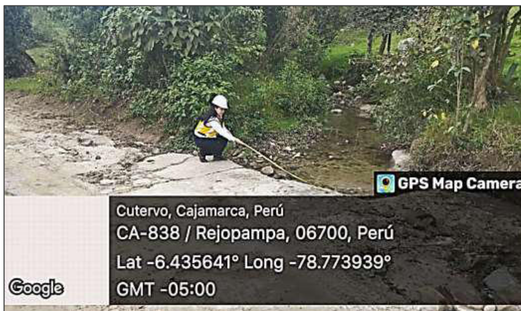
Imagen 10. Badén de concreto y piedra (A=6m L=7m), en la progresiva 03+601 en estado regular
