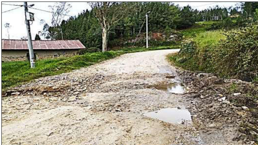
Imagen 4. Badén de tierra erosionado en la progresiva 00+500 km (A=5m L=6m)
