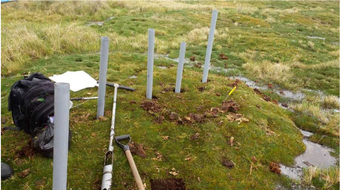
Figura 7. Instalación de los tubos de 2 pulgadas en las áreas de donde se extrajeron las muestras. Fuente: Elaboración propia.
