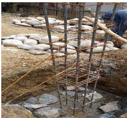
Figura 4. Vaciado de zapatas en las viviendas de la ciudad de Nueva Cajamarca.
