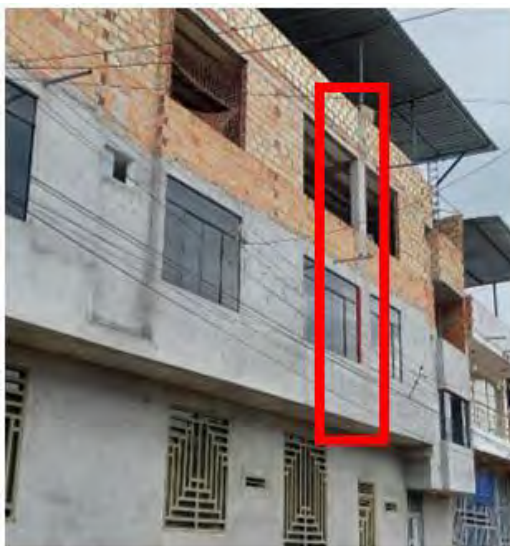
Figura 15. Vivienda con columna que tiene su base en voladizo.
