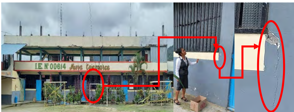
Figura 17. Elemento estructural (columna) agrietado de I.E. Manuel Gonzales Prada Fuente: Elaboración propia.
