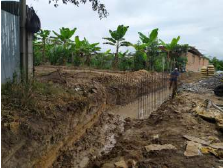
Figura 8. Proceso de instalación de acero para paredes y base de la alcantarilla. Fuente: Elaboración propia.
