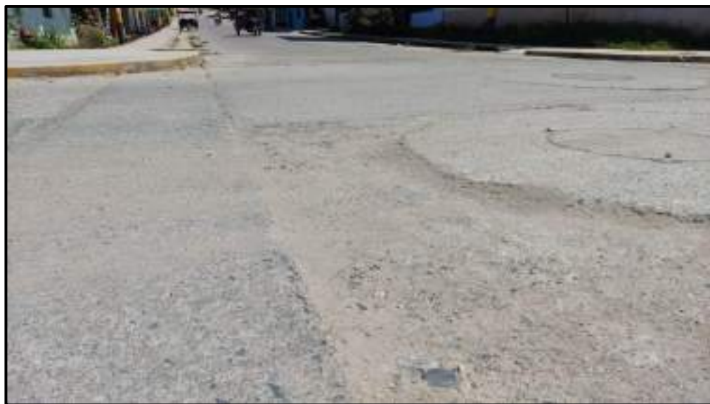
Foto N° 06: Falla por Dowels en la junta de construcción transversal al eje de la vía Fuente Elaboración Propia
