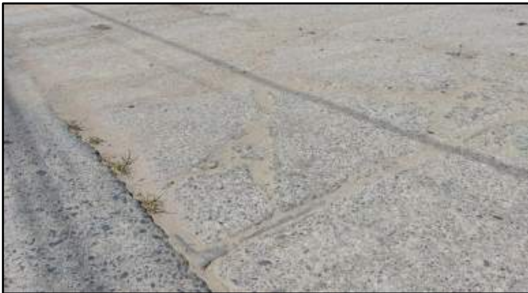
Foto N° 05: Baches discontinuos en el eje transversal del pavimento rígido Fuente Elaboración Propia
