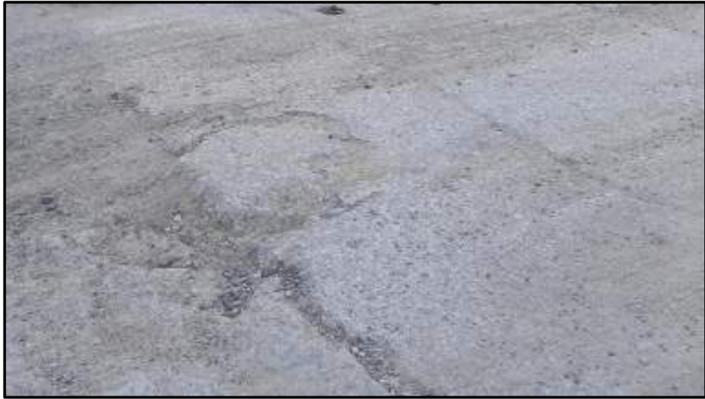
Foto N° 08: Falla por Dowels, en las juntas de construcción efectuando la liberación del material fino Fuente Elaboración Propia
