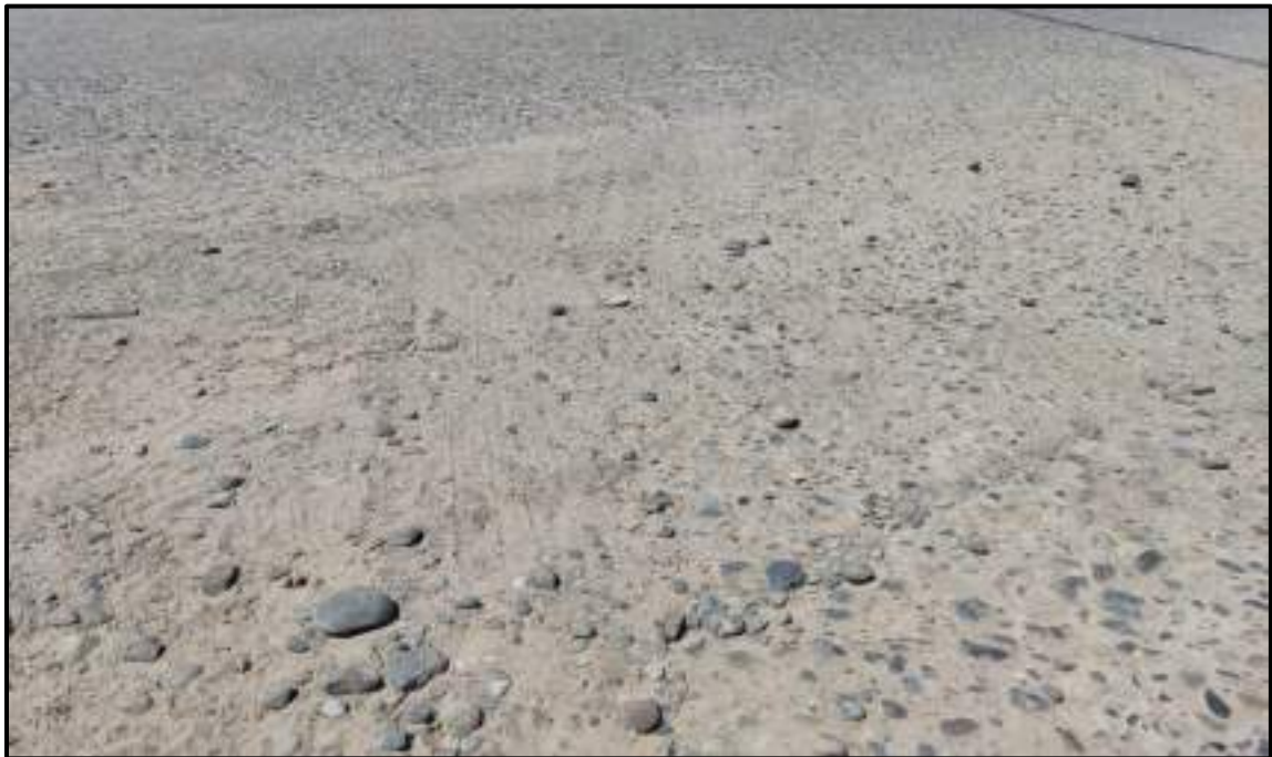
Foto N° 07: Falla de la junta de construcción efectuándose así liberación de material fino de la base del pavimento rígido (falla por bombeo)
