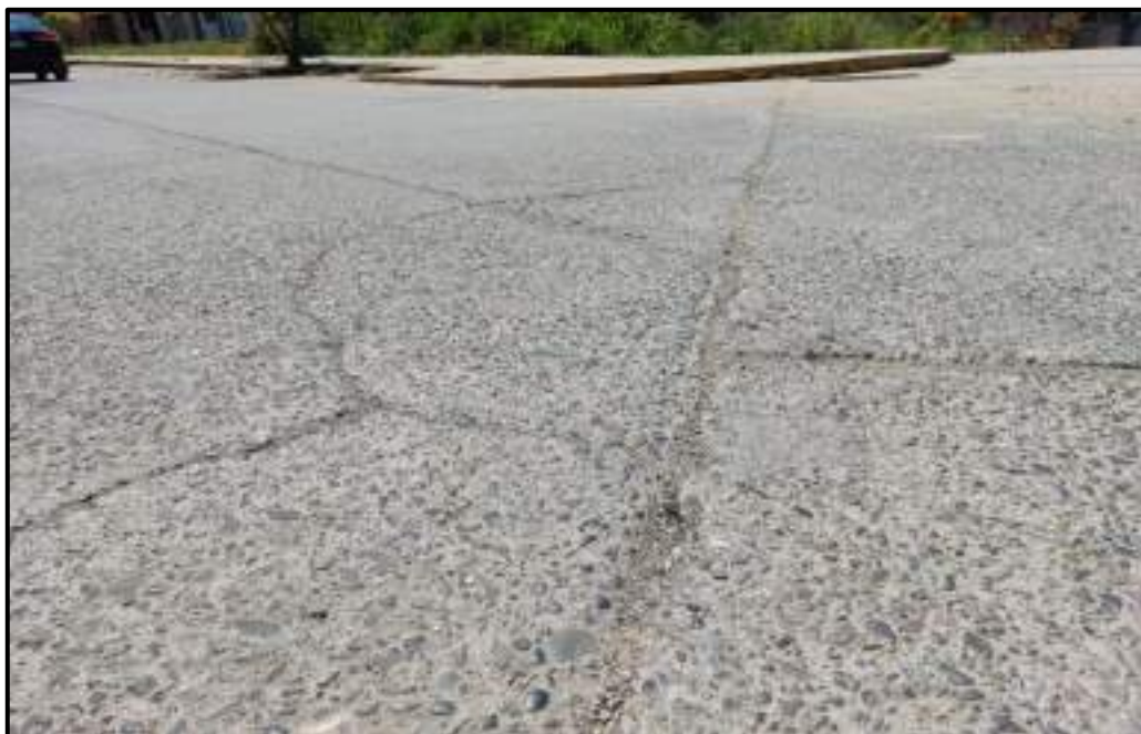
Foto N° 02: Deterioro de juntas Fuente Elaboración Propia
