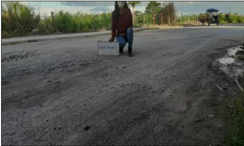
Foto N° 09: Falla de pavimento rígido en su totalidad, ocasionado por estructura de soporte (base)
