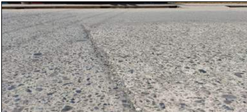
Foto N° 04: Falla en la junta transversal debido a solicitaciones vehiculares excesivas Fuente Elaboración Propia
