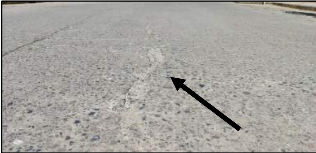
Foto N° 01: Fisuras y Agrietamiento. Cuadra 2 Fuente Elaboración Propia
