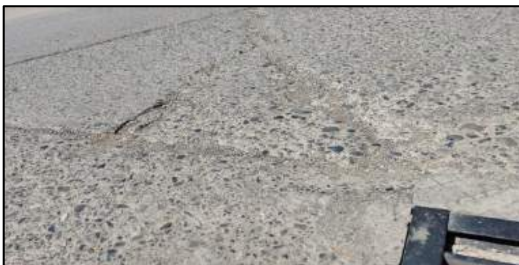
Foto N° 03: Falla por bombeo. Fuente Elaboración Propia
