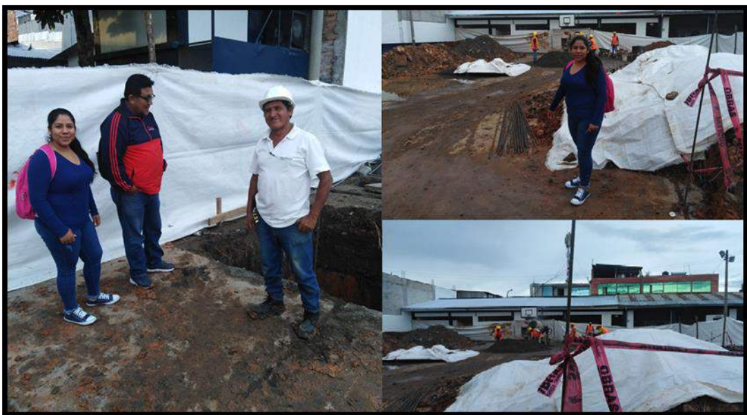
Figura 4: Verificación de los trabajos de excavación y coordinaciones con el equipo técnico para realizar mejoras en el diseño de la cobertura metálica.
