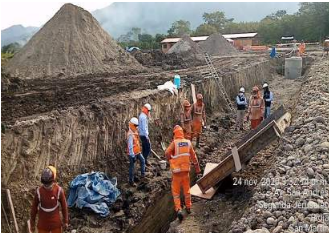
Figura 24: Línea de drenaje interno PTAR.
