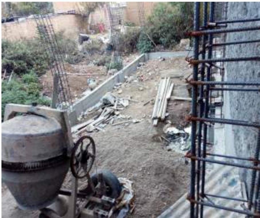
Figura 63. Inspección de construcción informal - Pasaje Zapatel
