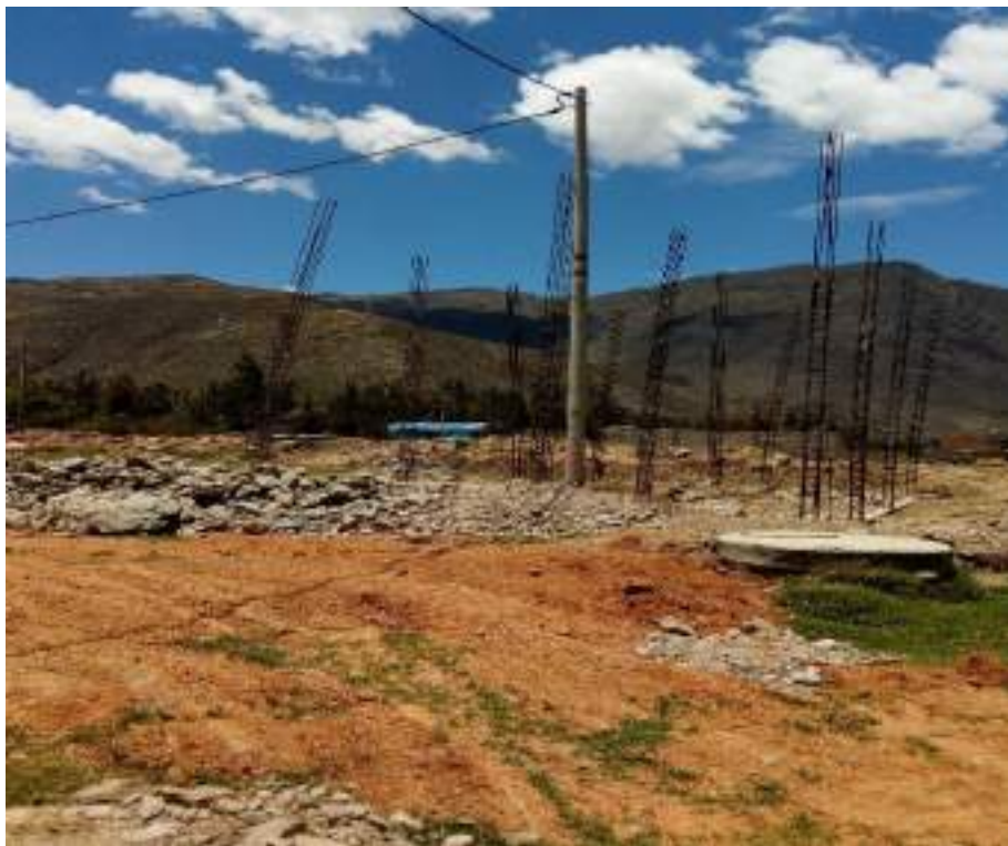
Figura 57. Inspección de construcción informal - Urbanización el Sol de Pomachaca
