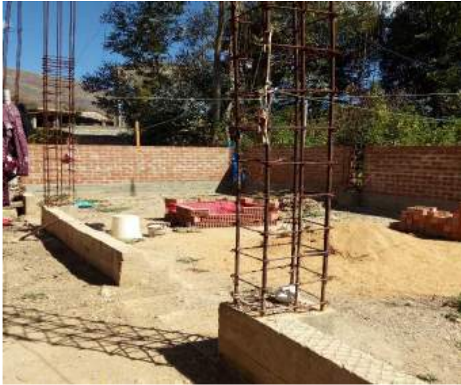
Figura 62. Inspección de construcción informal - Av. José Gálvez
