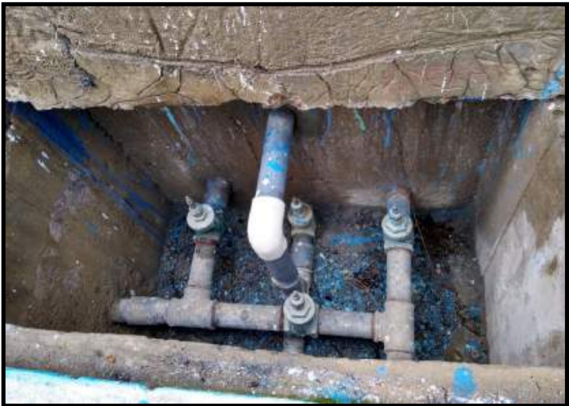
Figura 20. Estado de la Caja de Válvulas Fuente: Elaboración propia
