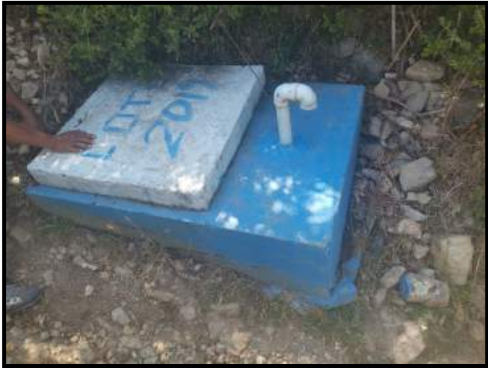
Figura 25. Estado situacional de la cámara rompe presión tipo 6 Fuente: Elaboración propia
