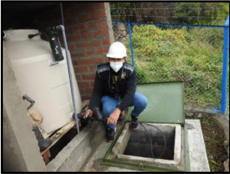
Figura 15. Instalación del Kit de cloración y graduación de goteo Fuente: Elaboración propia
