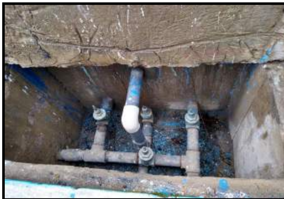
Figura 24. Estado situacional de la caja de válvulas Fuente: Elaboración propia
