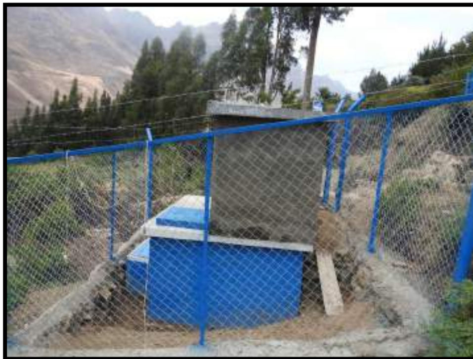
Figura 23. Se aprecia la instalación del sistema de cloración Fuente: Elaboración propia
