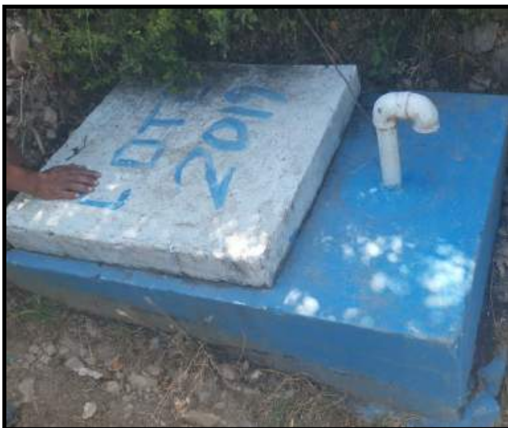
Figura 18. Estado de la Cámara Rompe Presión Tipo-06 Fuente: Elaboración propia
