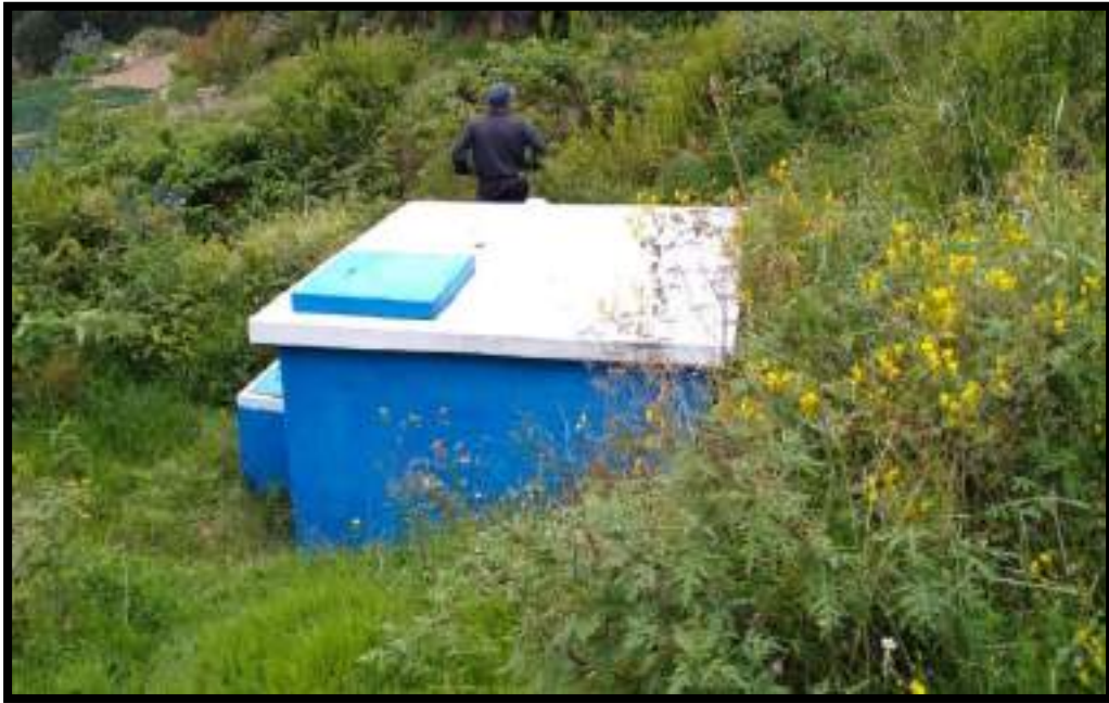
Figura 19. Estado del Reservorio Fuente: Elaboración propia
