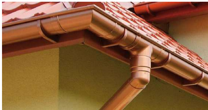
Figura 7. Canaletas de cobre
