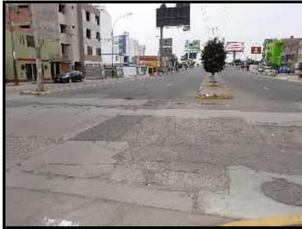
Figura 7. Pista de Concreto con superficie deteriorada.
