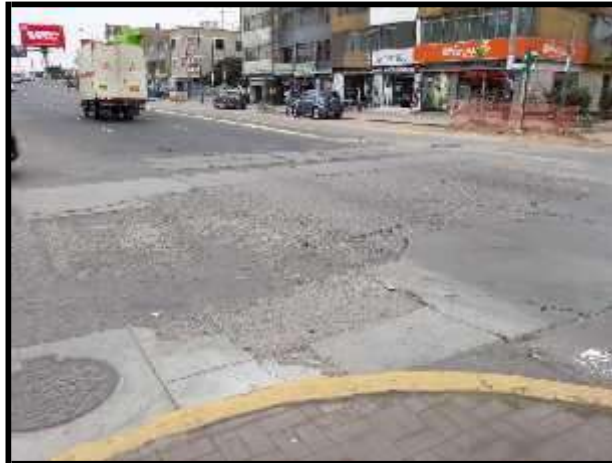
Figura 16. Desgaste de superficie de rodadura, estructura mixta del pavimento dañado con presencia de bacheo profundo.
