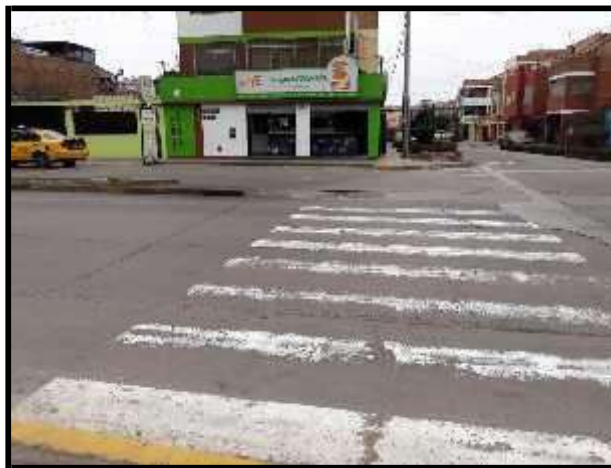
Figura 10. Presencia de fisuras longitudinales y transversales en la estructura del pavimento rígido.
