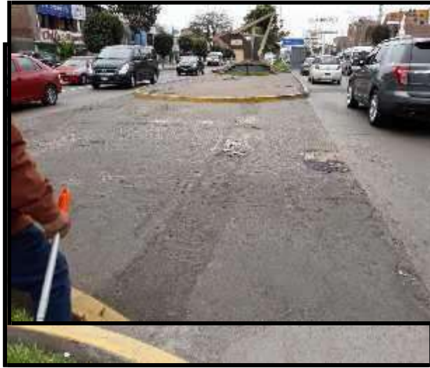
Figura 9. Pista de concreto deteriorada, resanada por obras de interferencias de empresa de servicio público.
