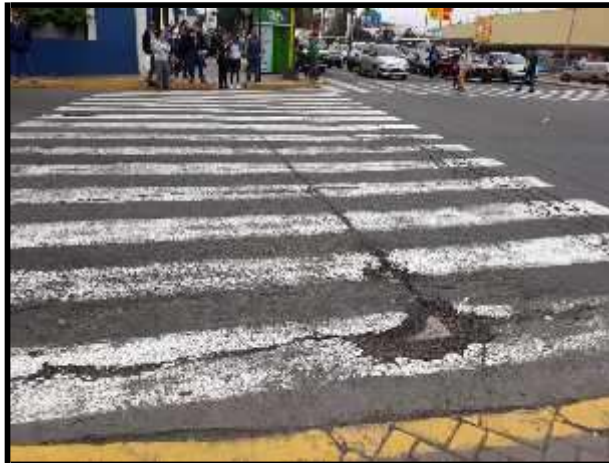
Figura 13. Cruce de carril con carpeta asfáltica deteriorada, presenta grietas y hundimiento.
