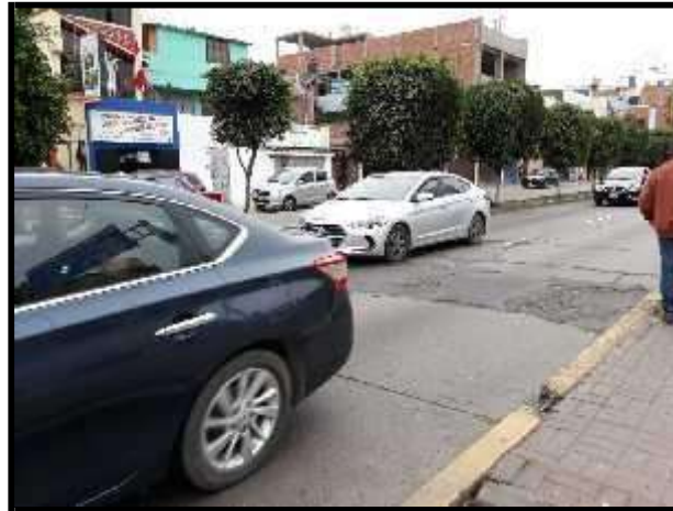
Figura 12. Pista de concreto deteriorada, resanada por obras de interferencias de empresa de servicio público
