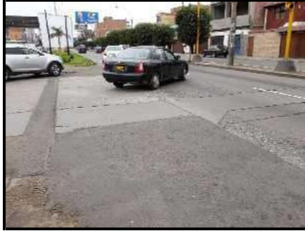
Figura 15. Presencia de grietas profundas en la estructura del pavimento rígido existente
