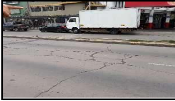
Figura 11. Desgaste de la superficie de rodadura, con presencia de bache profundo.
