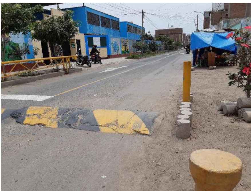
Figura 65. Pavimento con rompe muelle desintegrado Jr. San Hernán cuadra 2.
