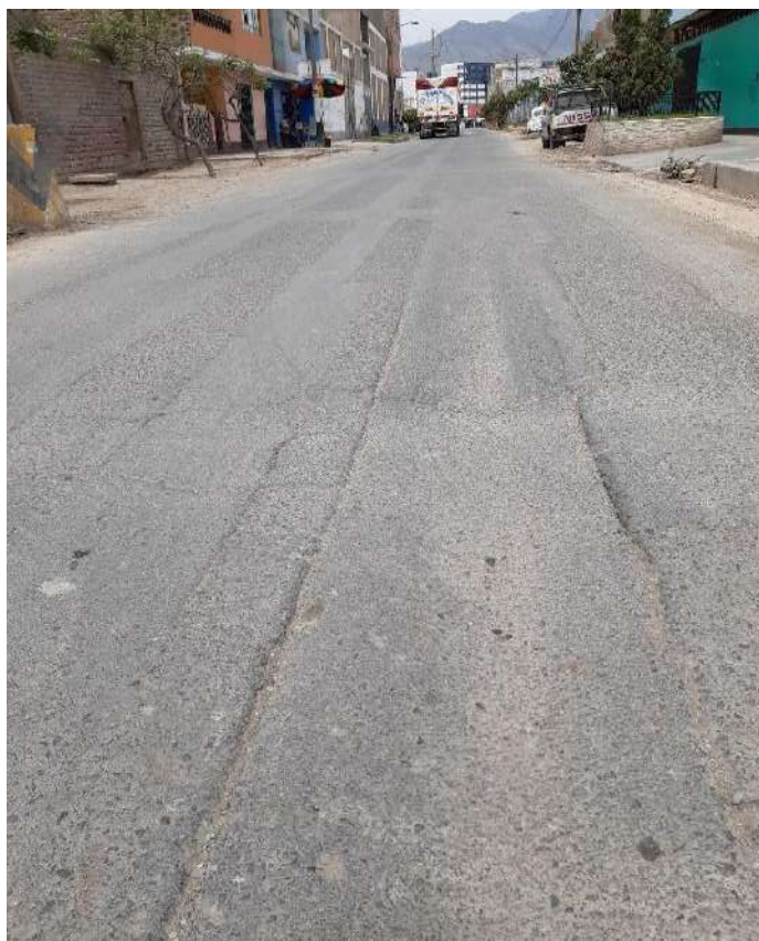
Figura 69. Pavimento con hundimiento Jr. San Hernán cuadra 3.
