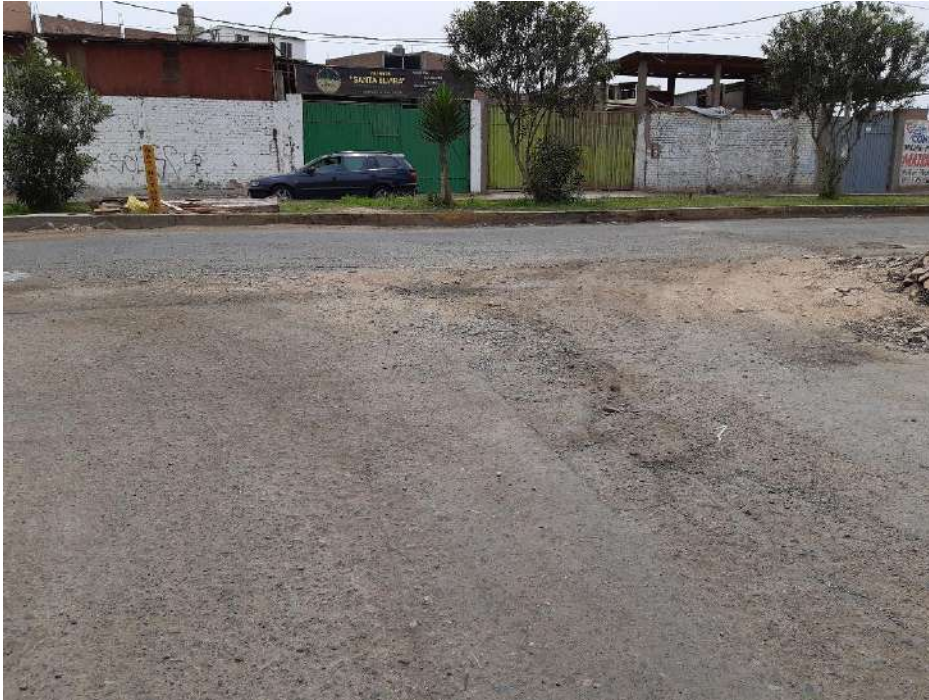
Figura 72. Pavimento deteriorado Jr. San Hernán cuadra 4 con Av. Santa Elvira.
