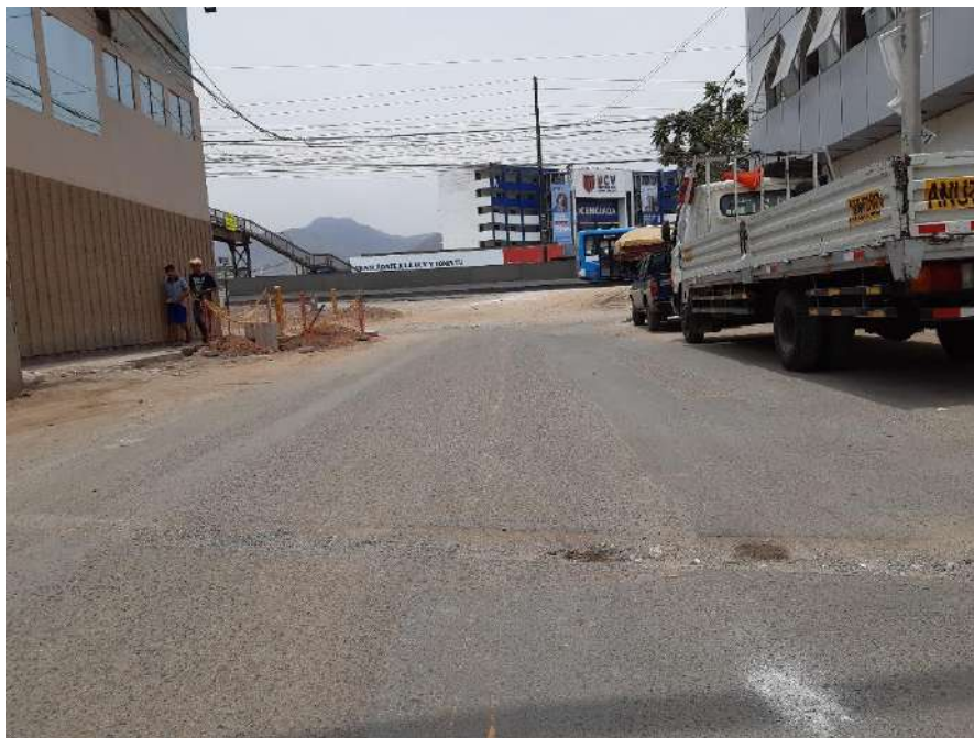
Figura 62. Pavimento con bache transversal Jr. San Hernán cuadra 1.
