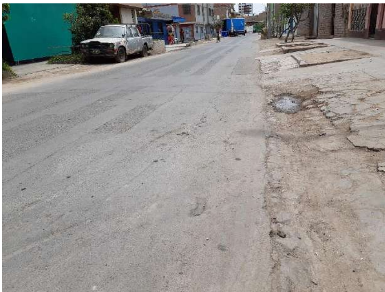
Figura 68. Pavimento con baches y ahuellamiento Jr. San Hernán cuadra 3.
