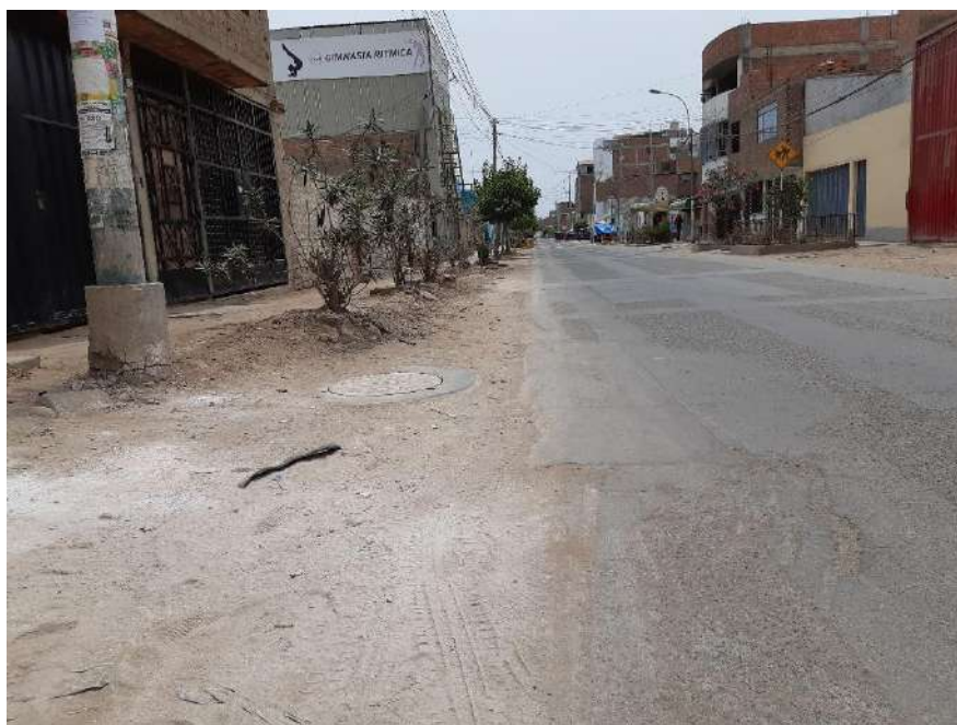
Figura 63. Pavimento con fisuras y desintegración Jr. San Hernán cuadra 1.
