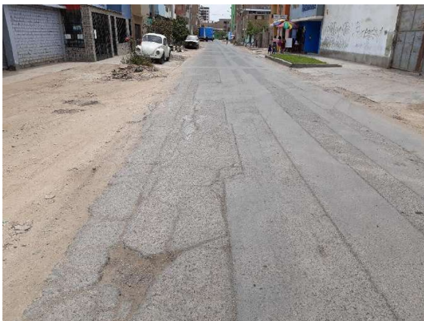
Figura 67. Pavimento con falla de borde y desprendimiento Jr. San Hernán cuadra 3.
