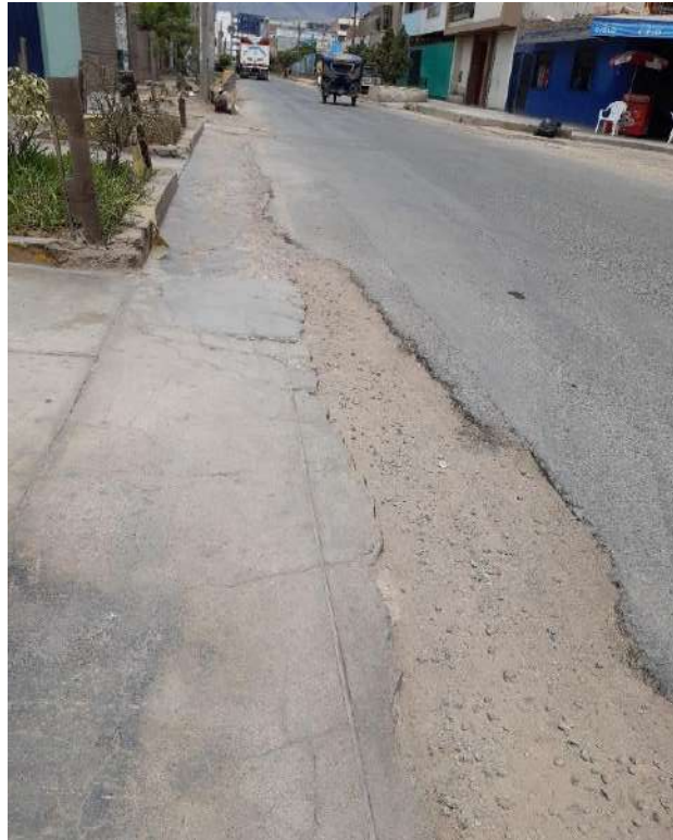
Figura 70. Pavimento con falla de borde Jr. San Hernán cuadra 4.
