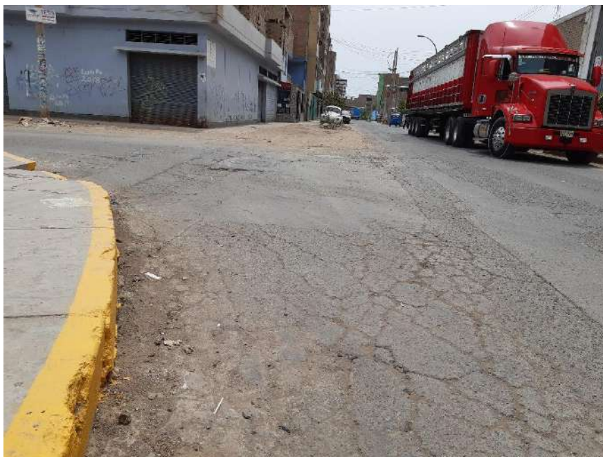
Figura 66. Pavimento con falla en forma de polígono Jr. San Hernán cuadra 2.
