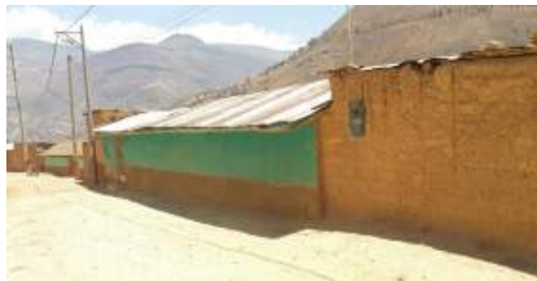
Figura 36. Edificación de adobe sin una adecuada cantidad de muros ortogonales.
