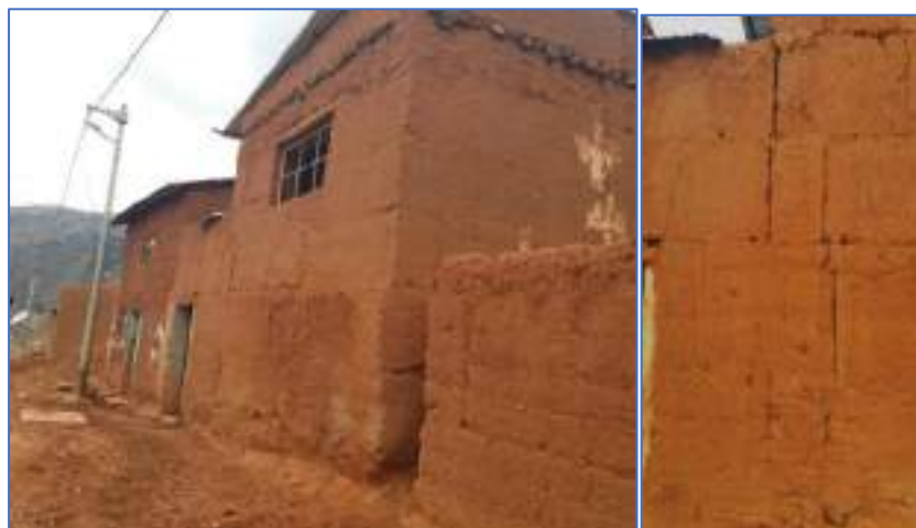
Figura 44. Edificación de tapial en mal estado de conservación.
