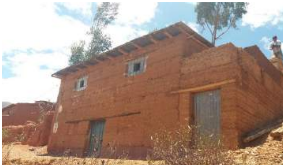
Figura 34. Edificación de tapial sin arriostramiento horizontal.
