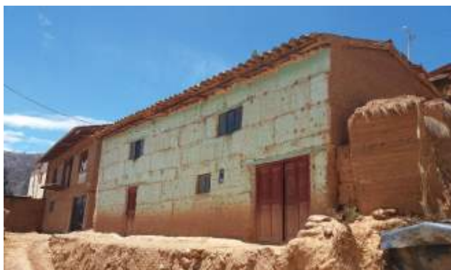
Figura 41. Edificación de tapial con excesiva separación de muros.
