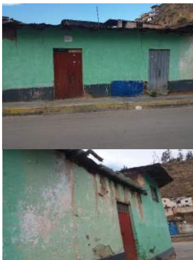
Figura 37. Edificación de tapial con presencia de humedad en el sobrecimiento y muros.
