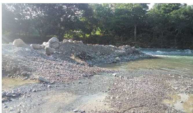
Figura 56. Extracción de material de construcción dentro del cauce del río Yuracyacu, año 2018.
