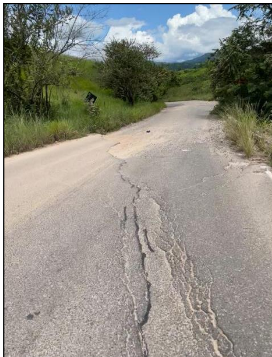
Fotografía N°01 y 02: Fallas que presentan el tramo de Cuñumbuque.
