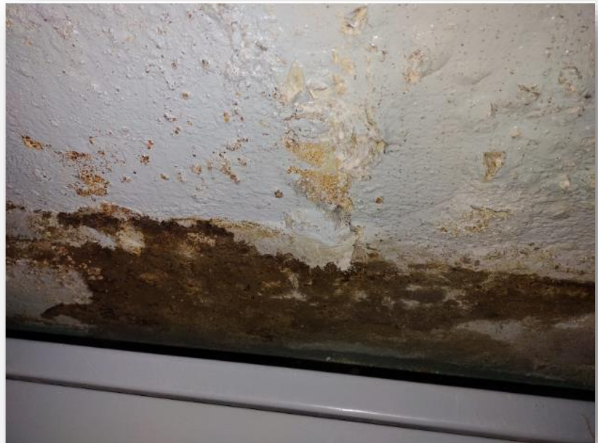
Salitración por humedad
