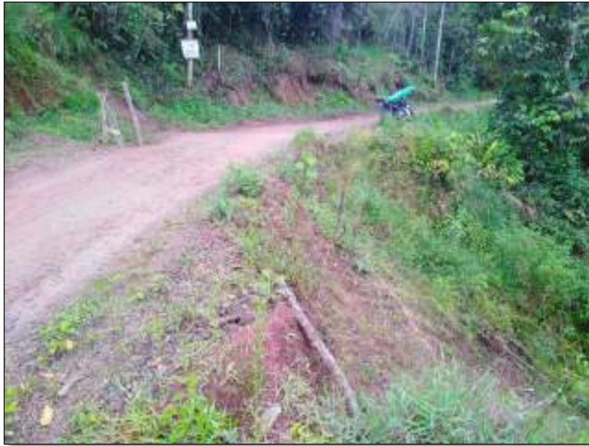
Figura 18: Se observa el estado actual de la vía y la necesidad del muro de sostenimiento (fuente: propia)
