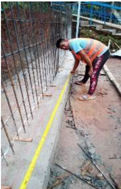
Fotografía 12. Falta de control en los trabajos por parte de la gerencia
