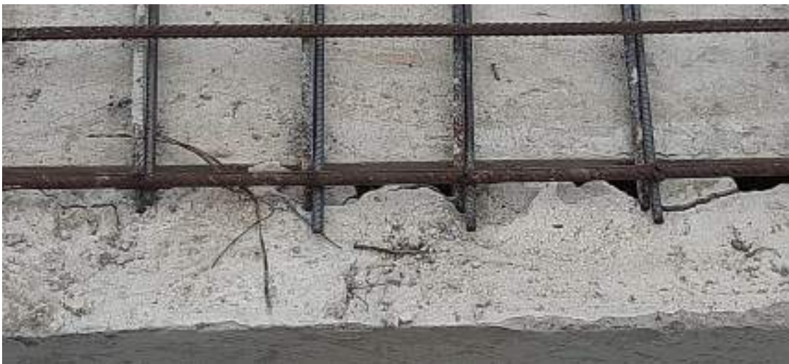
Fotografía 10. Poco recubrimiento para el acero.
