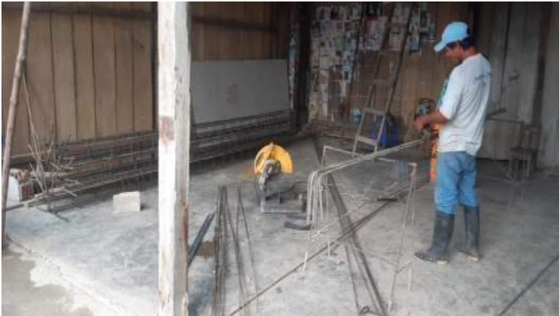
Figura 4 Inadecuado uso de Epp's
