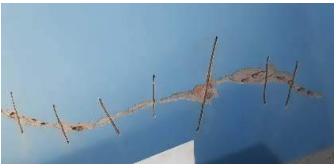
Fotografía 2. Estructuras de muros con grietas
