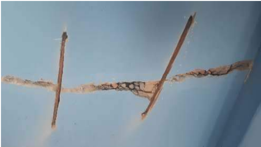
Fotografía 3. Estructuras de muros con grietas pronunciadas
