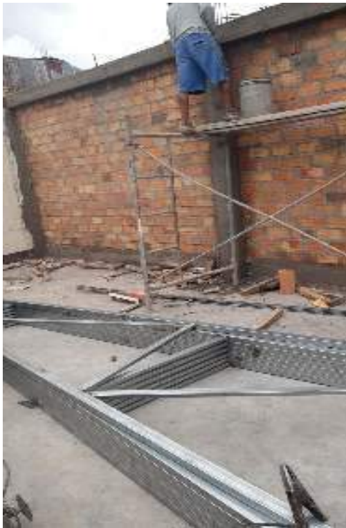
Fotografía 11. Personal laboral sin EPP's y sin vestimenta adecuada
