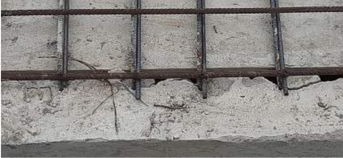
Figura 2 Mala calidad de los materiales
