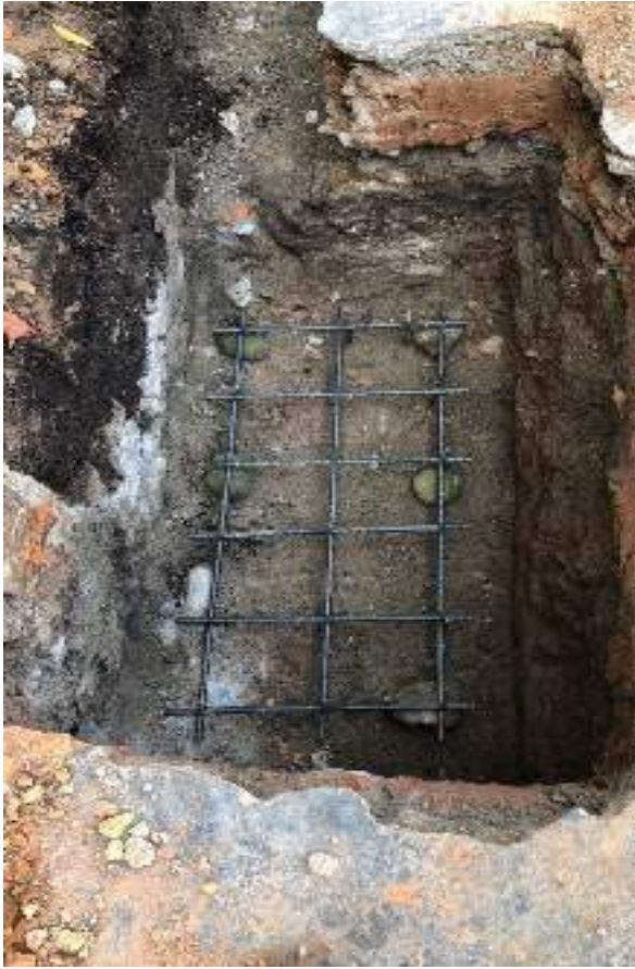
Fotografía 9. Inadecuada colocación de parrilla para una zapata.
