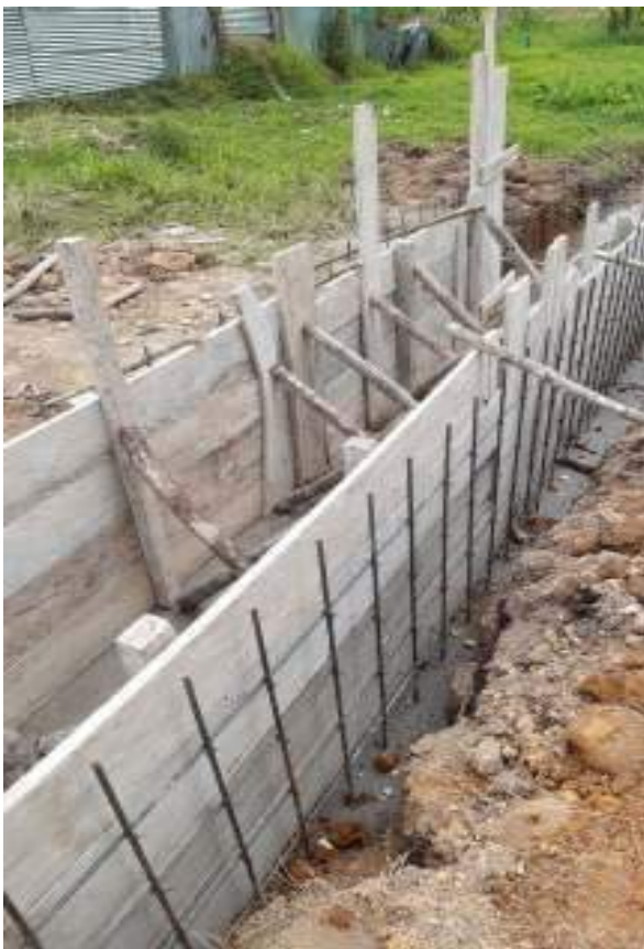
Fotografía 8. Inadecuado encofrado para una alcantarilla.
