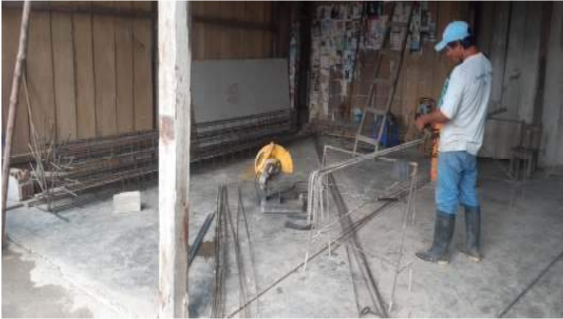
Fotografía 5. Personal laboral sin EPP's y sin vestimenta adecuada
