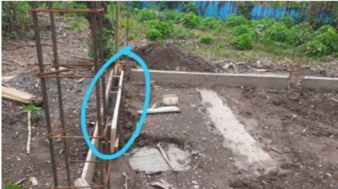
Figura 3 Mal proceso de construcción: falta viga de cimentación
