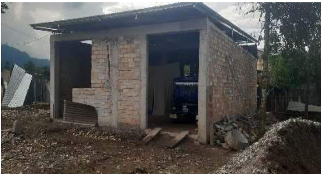
Fotografía 1. Obras inconclusas con tiempo de entrega vencido
