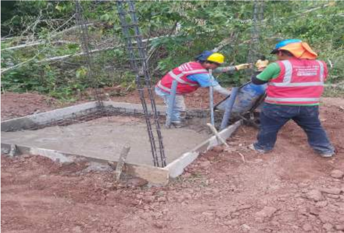
Figura 12: Vaciado de concreto f'c = 210 \text{ kg/cm}^2 , para la losa de un modulo
