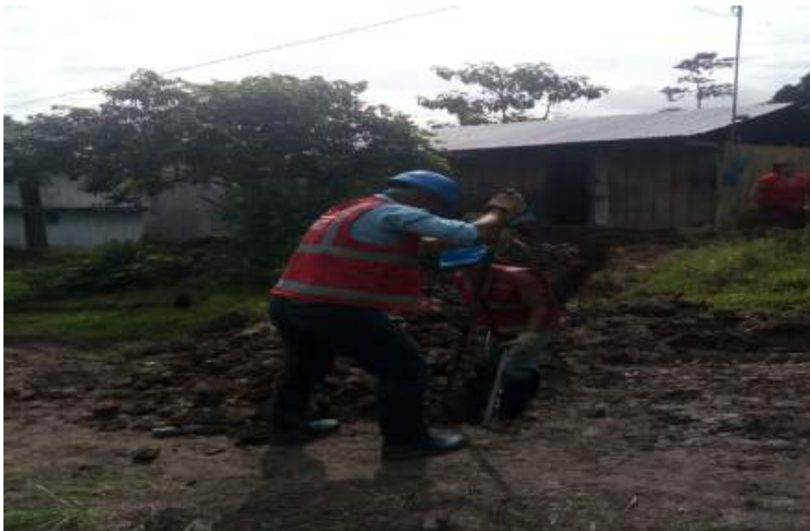
Figura 16: Excavación de la zanja de 0.40 x 0.70 m para la línea de conducción.
